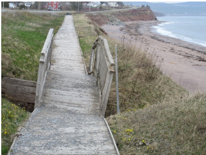
Il est judicieux d'inclure un budget pour l'entretien des infrastructures dans un projet de revitalisation. Crédit photo : Emmanuelle Bouchard-Bastien (2018).
